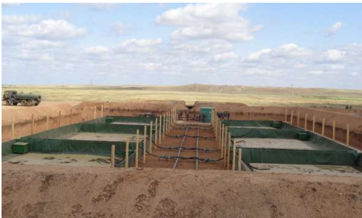
Рис. 1. Резервуарная группа полевого склада горючего ПСГ-600 (перед заполнением)
